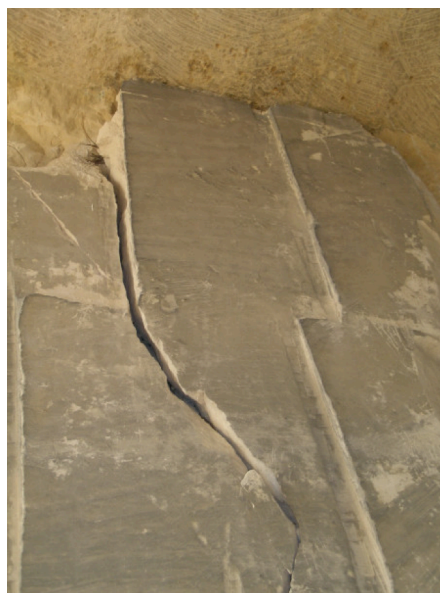
Fig. 11.2 typische barstvorming op de hoek van een pilaar (Zonneberg vanuit ENCI-groeve)
